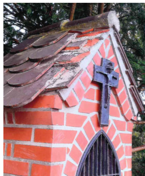
Schaden am Marterl „14 Nothelfer“ an der Liebigstraße
